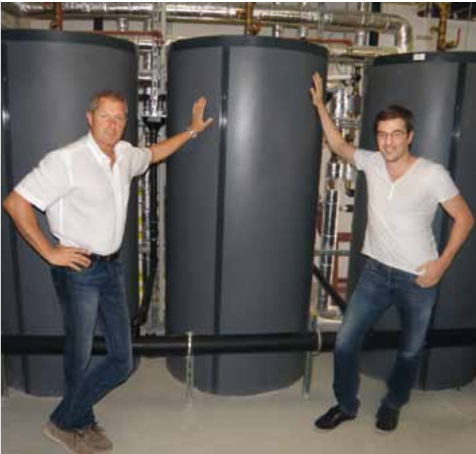
Fritz Walch, Projektleiter Hasenauer Anlagenbau, und Florian Dachs-Wiesinger, Habau Hoch- und Tiefbaugesellschaft, vor den Link3 Speichern (v.l.n.r.).
