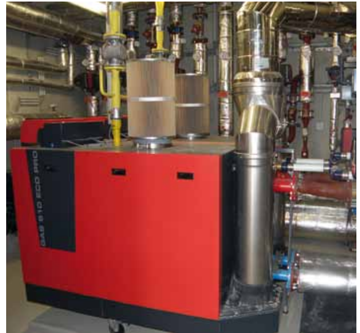
Zwei modulierende Remeha-Brennwert-Gaskessel für Heizung und Warmwasser sorgen für eine maximale Leistung von 666 kW.
