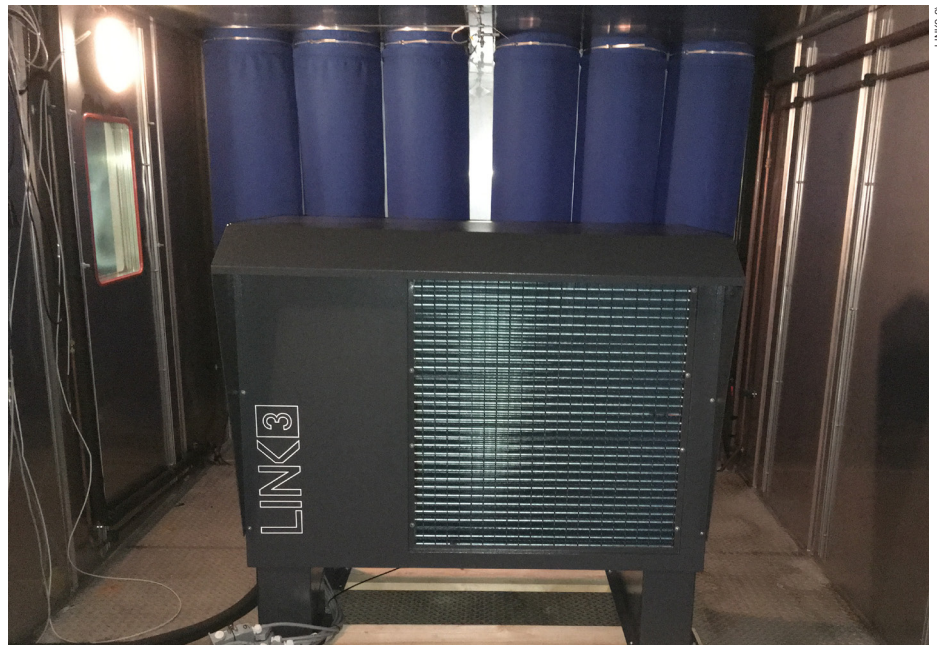
Die Außeneinheit LINK3-AIRLINK in der Klimakammer des Instituts für Solartechnik SPF an der HSR Hochschule für Technik in Rapperswil am Zürichsee in der Schweiz.
